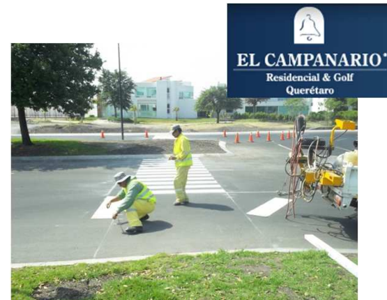
Fracc. El Campanario, Querétaro, Qro. Señalamiento vertical y horizontal.
